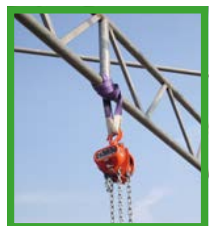
Figuur 33: De positie van de takel is OK (zolang de fabrikant van de leng deze toepassing accepteert).
